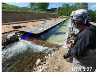
[バイパス水路] 試験余水吐施設スモルト降下状況確認
