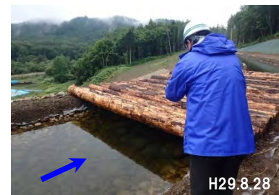
[バイパス水路] カバー部の流況確認
