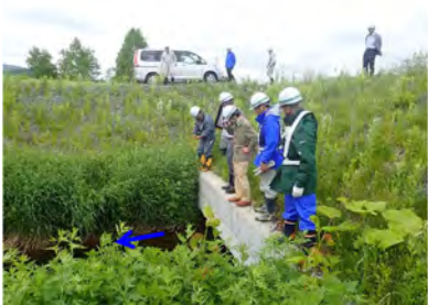
(6/18バイパス水路)流況確認
