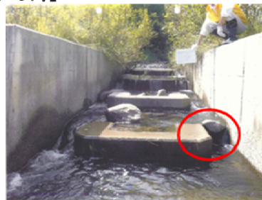
魚道部の土砂埋塞状況
