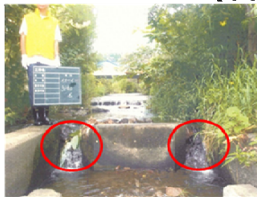
魚道部の土砂埋塞状況
