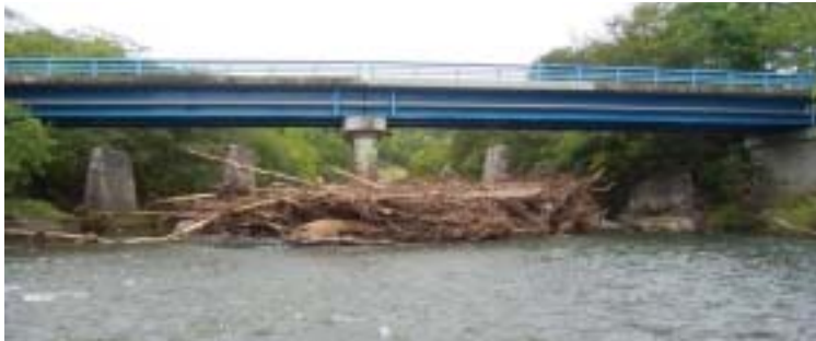
<出水時の流木発生事例> 増水時に流木やゴミ等が河川に流出
