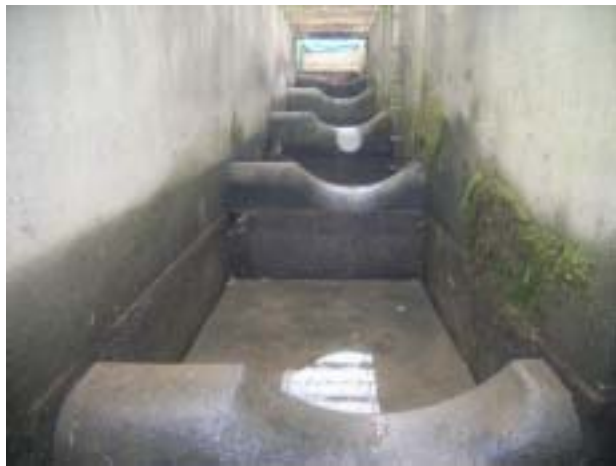
改善前 (越流部はく離の発生)
