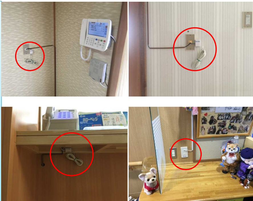
特設公衆電話回線設置状況
