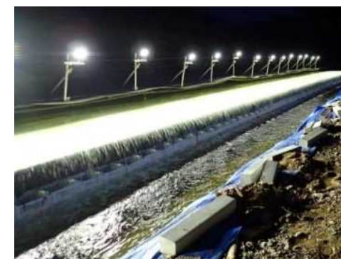
夜間の照明点灯状況
