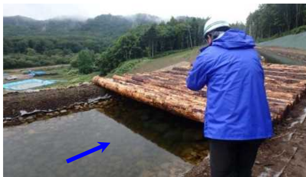
(8/28 バイパス水路) カバー部の流況確認
