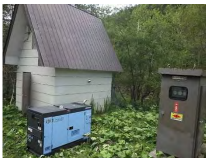
美瑛町浄水場(旭川河川事務所)
