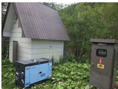
美瑛町浄水場(旭川河川事務所)
