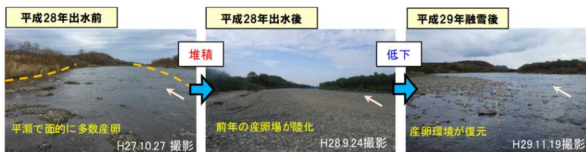
写真- 24 美深橋下流における平成 28 年 8 月出水前後の現地状況
