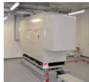
非常用発電設備のイメージ
