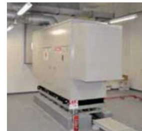
非常用発電設備のイメージ
