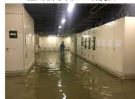
地下電源設備の浸水被害
