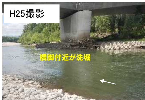
橋脚付近の洗堀状況
