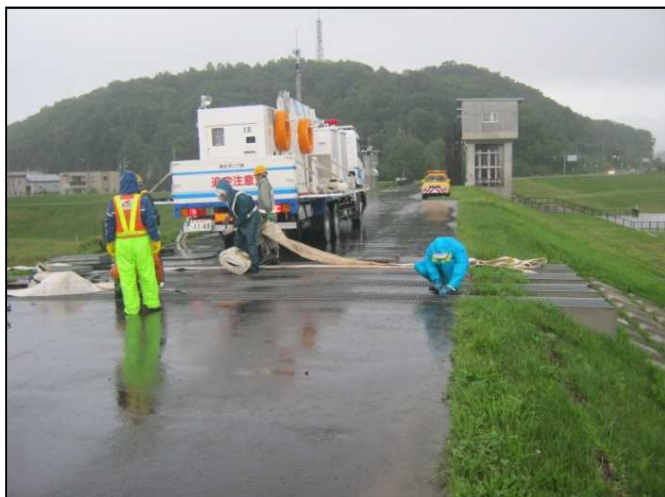
神居第4樋門（石狩川）排水ポンプ設置状況
