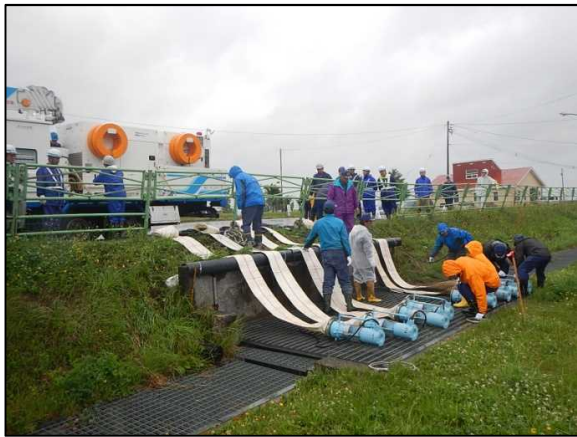
災害対策ポンプ車設置状況
