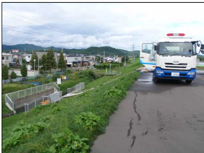
神居第3樋門（忠別川）排水ポンプ車稼働状況
