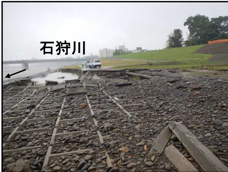
石狩川 新橋下流左岸 低水護岸被災状況
