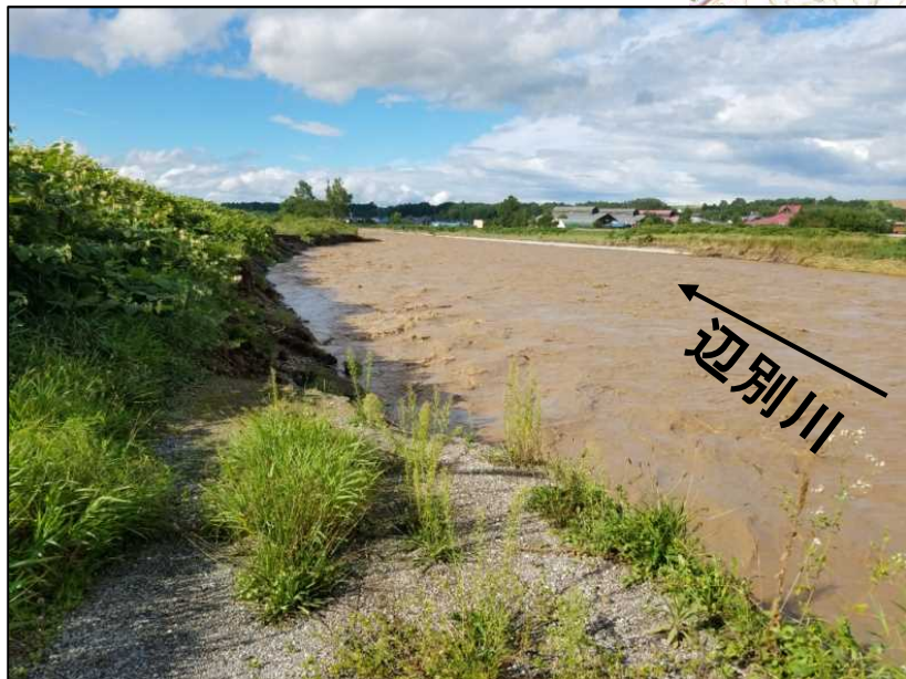
辺別川 左岸KP6.0mk付近 河岸侵食状況
