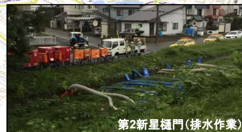
石狩川 第2新星樋門(排水作業)
