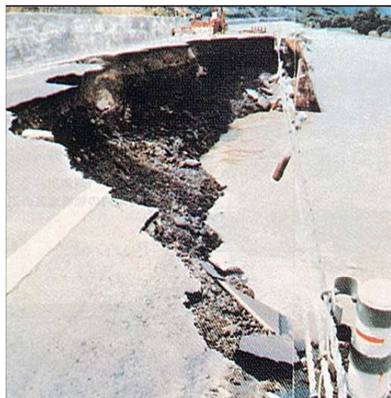
天塩川左岸 国道40号線の決壊状況 (中川町地先)
