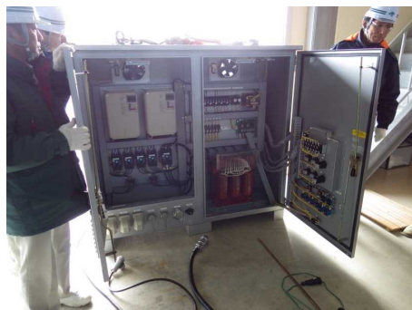
ポンプパッケージ （制御盤側）内部
