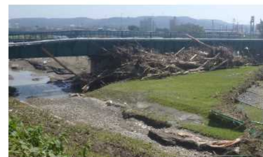
流木による断面阻害状況(久慈川)
