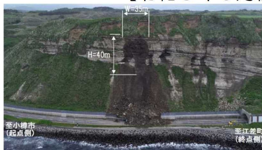
▲被災箇所全景
