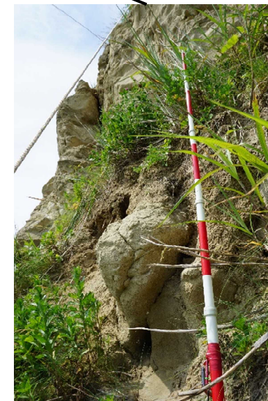
O. 亀裂間所々開口し土砂挟在
