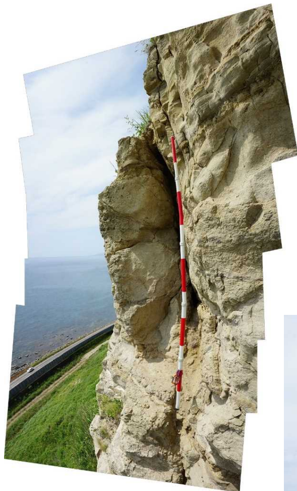
O. 亀裂状況（走向傾斜；N21W90）
