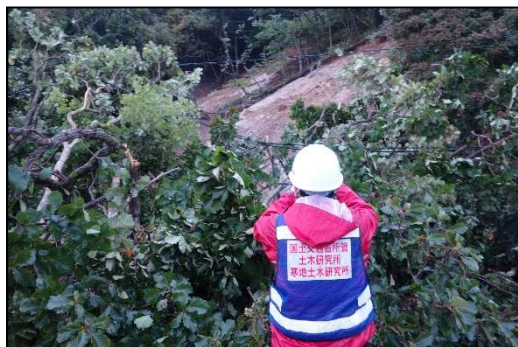
【国道付近地すべりの現地状況】
