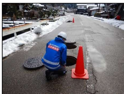
【被災施設の調査】
