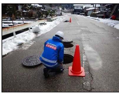
【被災施設の調査】
