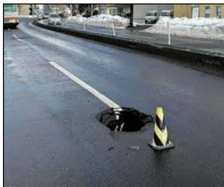
道路陥没における技術指導① 【発生初期の状況】
