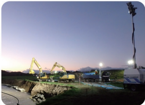
河岸浸食箇所の応急復旧状況 (平成 28 年 8 月 釧路川)
