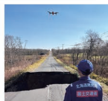
令和7年 大雨による被災状況調査(浜中町)
