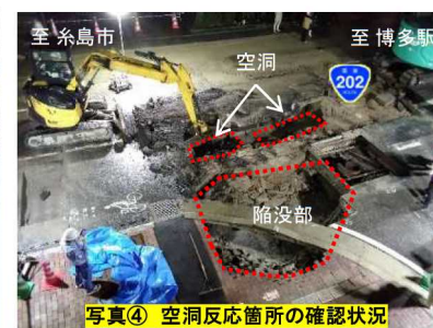
写真④ 空洞反応箇所の確認状況
