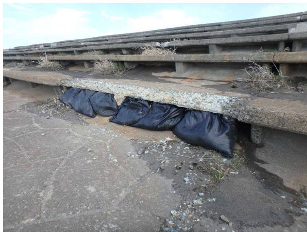
階段護岸木枠に一部損傷: 木杭にて明示
