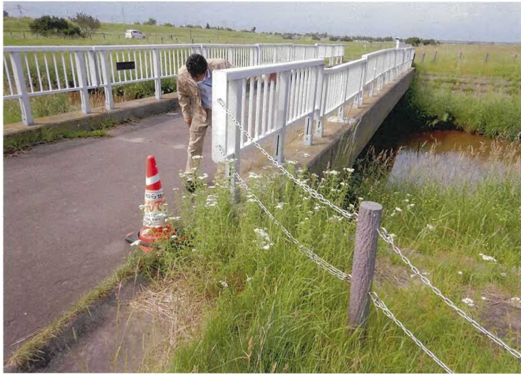
手摺り柱下部損傷
