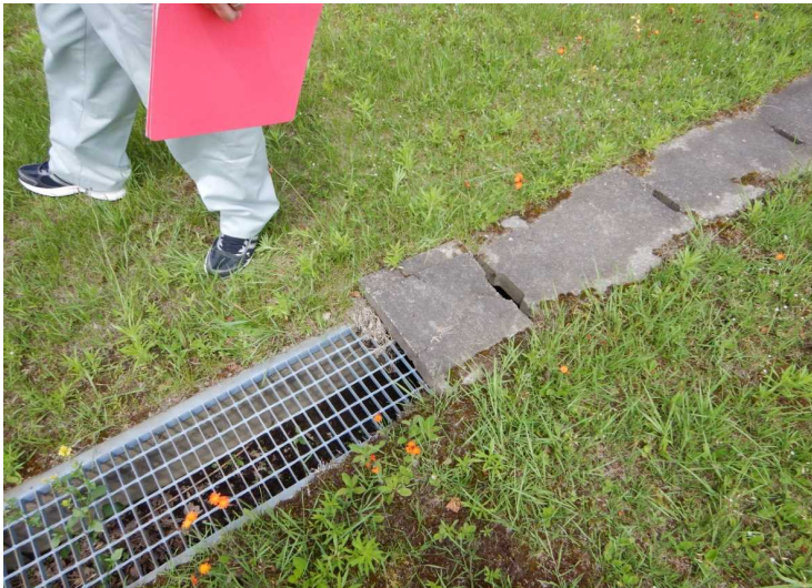
排水溝蓋損傷
