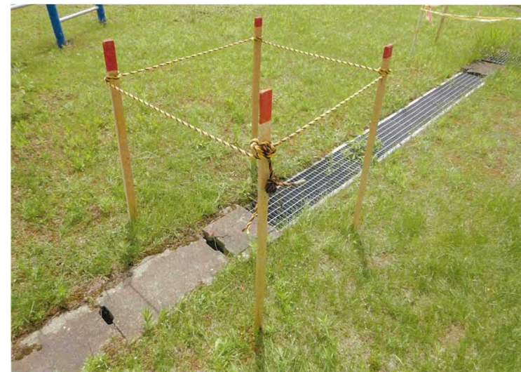
損傷箇所周囲をトラロープで囲い注意喚起
