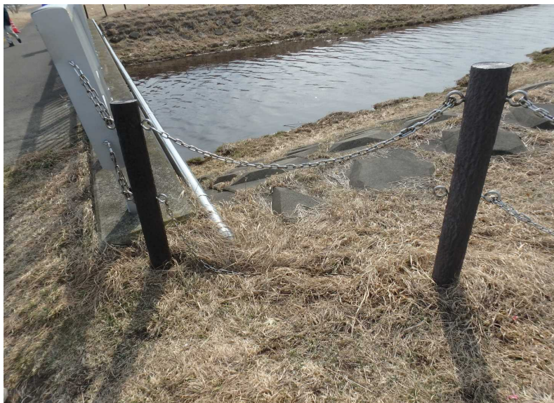
防護柵チェーンの接続部破損
