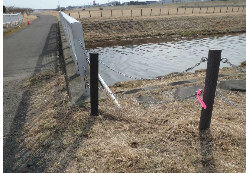
防護柵チェーンの接続部応急処置
