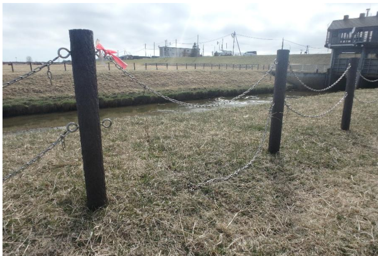
防護柵チェーンの破損
