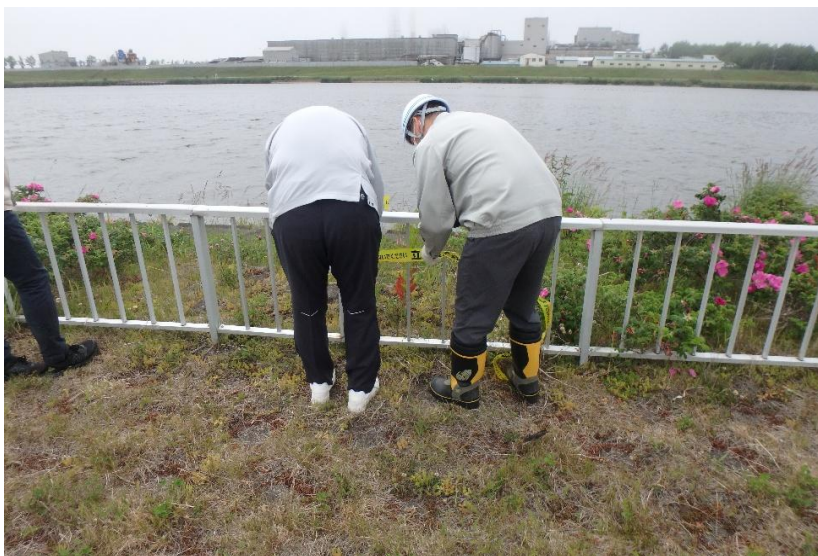
立入防止柵の破損
