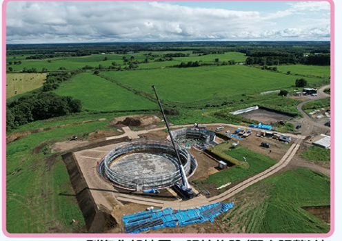
別海北部地区 肥培施設(配水調整池)
