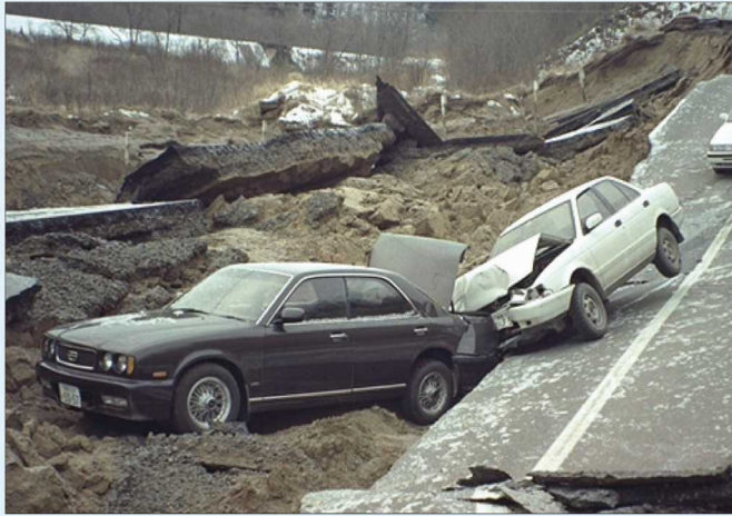
釧路沖地震（1993.1.15） 崩壊した道路に巻き込まれた車両（国道4号厚岸町糸魚沢）
