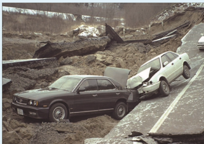
釧路沖地震（1993.1.15） 崩壊した道路に巻き込まれた車両（国道4号厚岸町糸魚沢）
