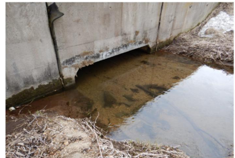
土砂堆積による排水路の機能低下
