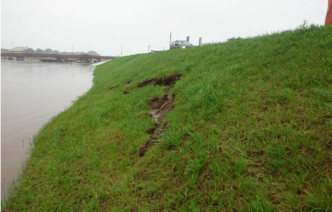
被災時(亀裂発生状況)
