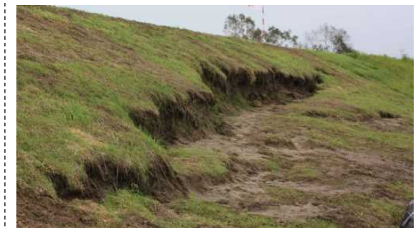
平成28年に発生した法面の被災状況(標茶町)
