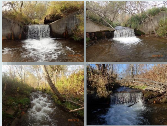
下流： 落差工が遡上障害
