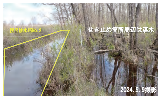
排水路をせき止めたことで周辺が湛水
