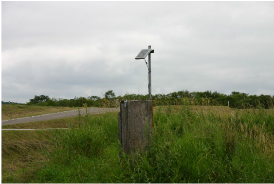
太陽光発電設備支柱
