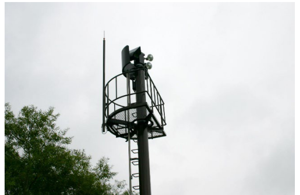
警報設備支柱
