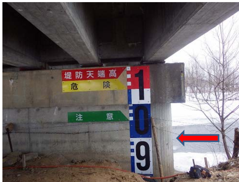
舌辛川(釧路市)に設置した量水標(令和5年度設置)
