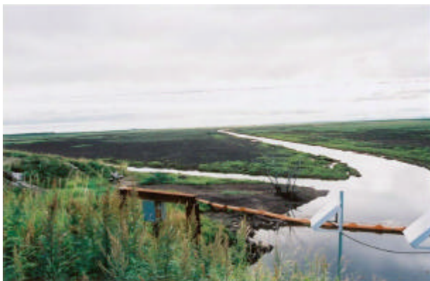
写真 湛水試験終了後の試験地の状況 雪裡樋門上より撮影 (平成 15 年撮影)
