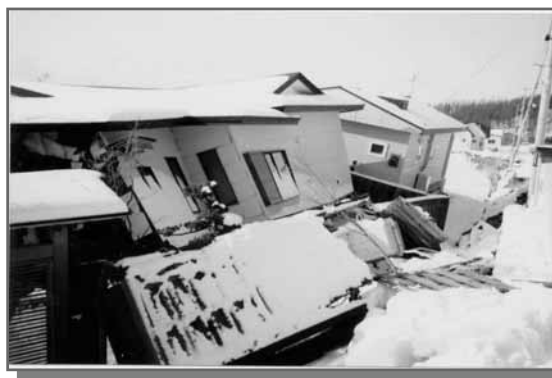
地盤沈下による家屋の被害
