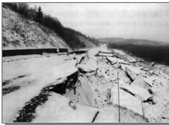
道路盛土の崩壊
