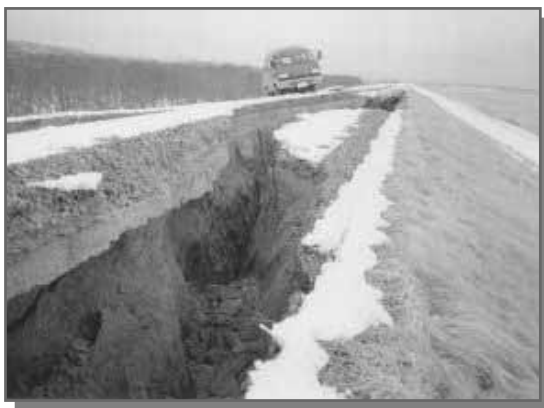
天端が陥没した釧路川の築堤
