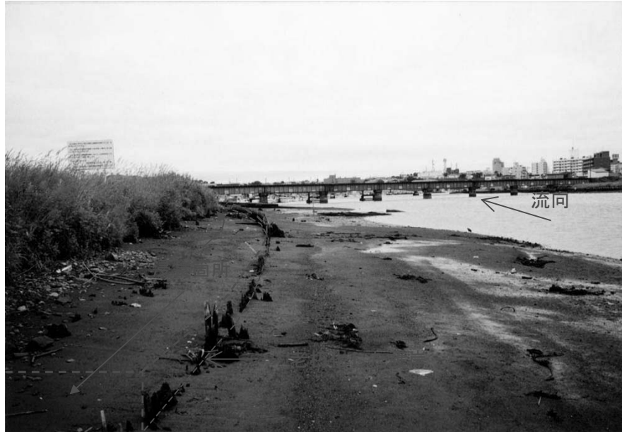
写真 1-7 河岸の浸食状況(JR 橋上流左岸)
