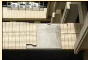
外壁タイルの落下
