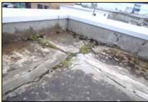
屋上防水押えコンクリートの損傷
