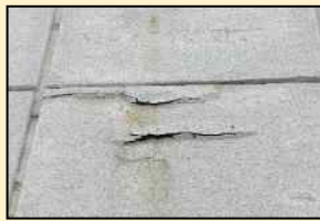
外壁外装材の浮き
