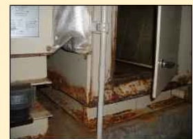
ユニット型空調機の腐食
