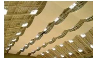
LEDを導入した体育館内アリーナの高天井
