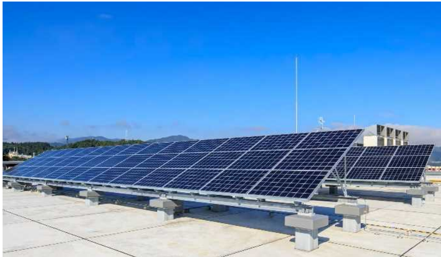
太陽光発電設備
