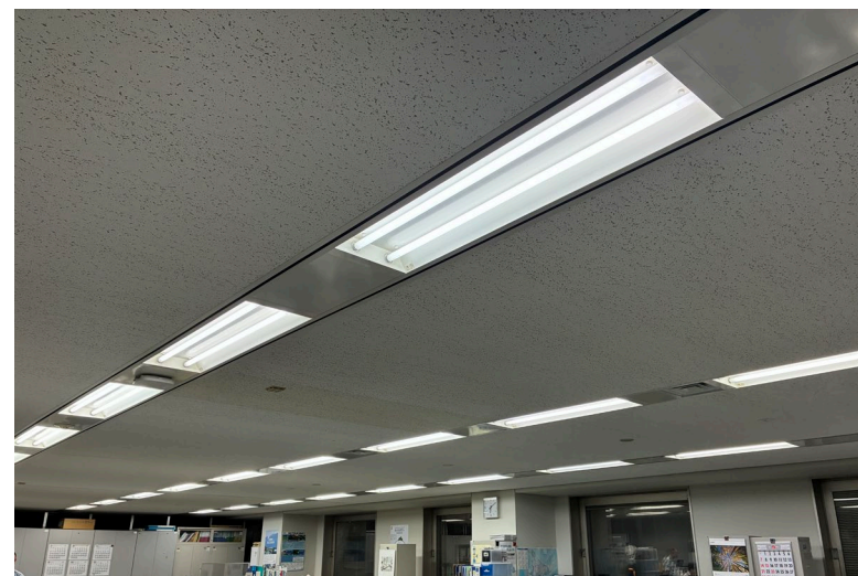
北海道地方環境事務所 執務室の照明
