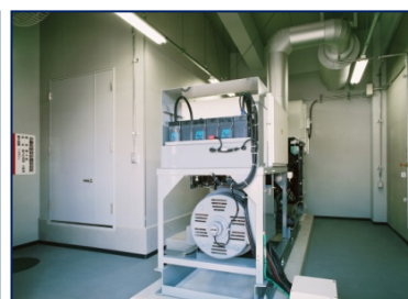
【自家発電機室】
