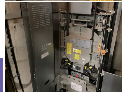
巻上機 制御盤
