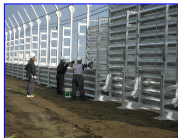
防雪柵の整備
